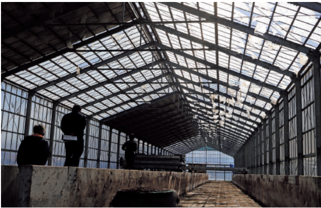
屋根が破れている状態
