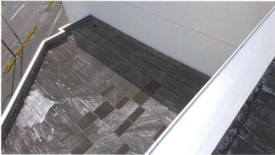
他の未改修屋根、補修跡が見られる。
