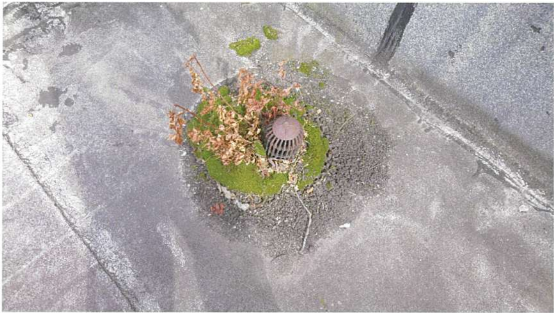
雨漏りが確認されたドレイン 土が溜まり、コケが生えている。ドレインの管理が十分でない。
