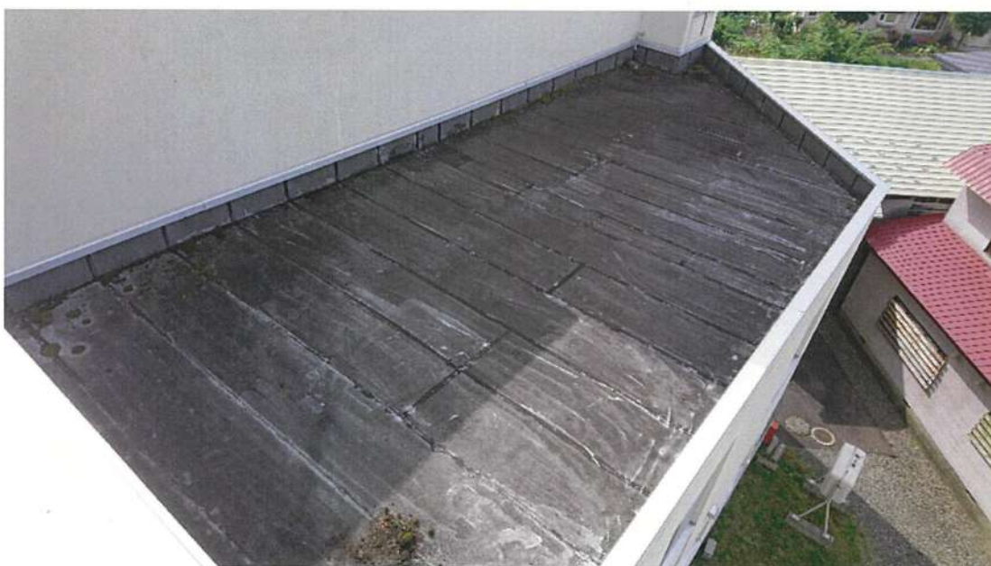
雨漏れしている屋根
