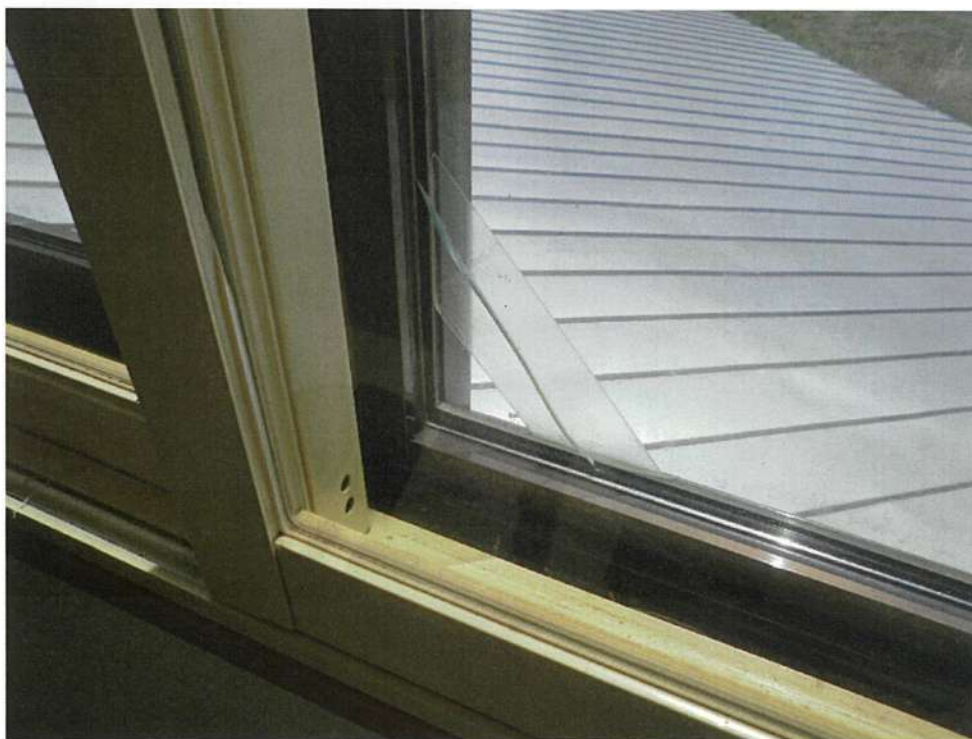
ペアガラスの外側破損
