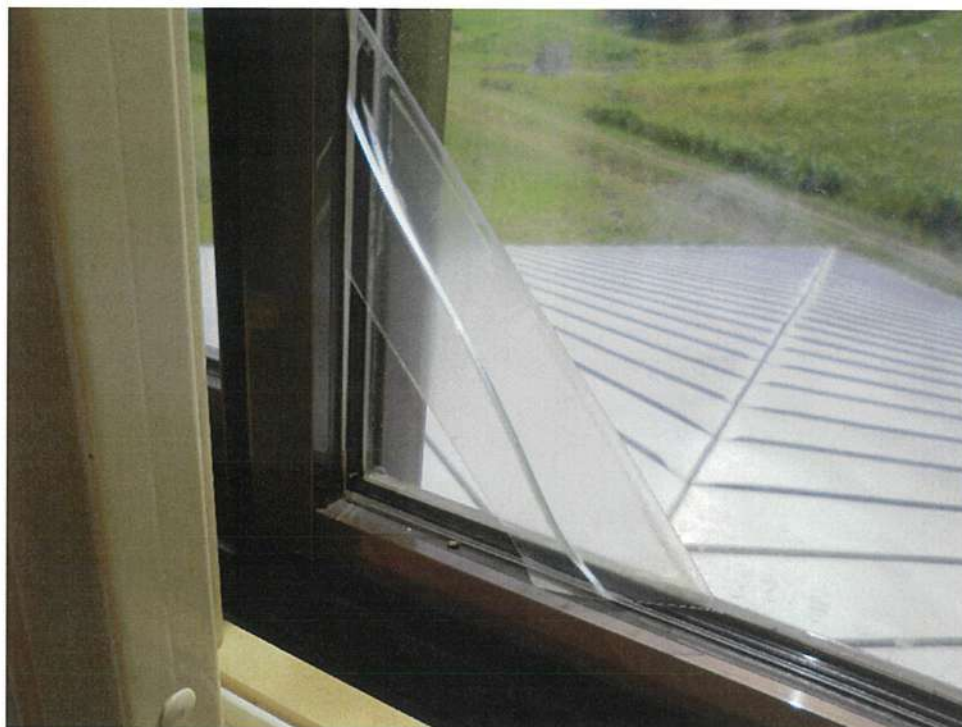
ペアガラスの内外破損
